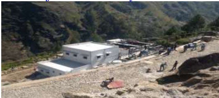
Joshimath STP 1- 1 MLD
