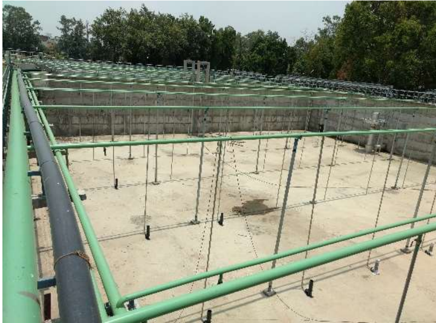
Beur STP (43 MLD), Patna
