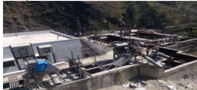
Joshimath STP 2- 2.7 MLD
